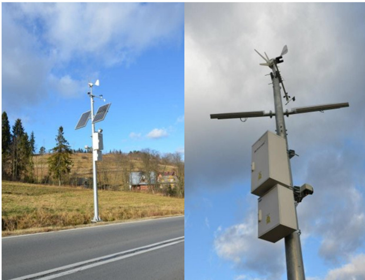
Fotografia 1. Stacja monitoringu przy drodze wojewódzkiej
