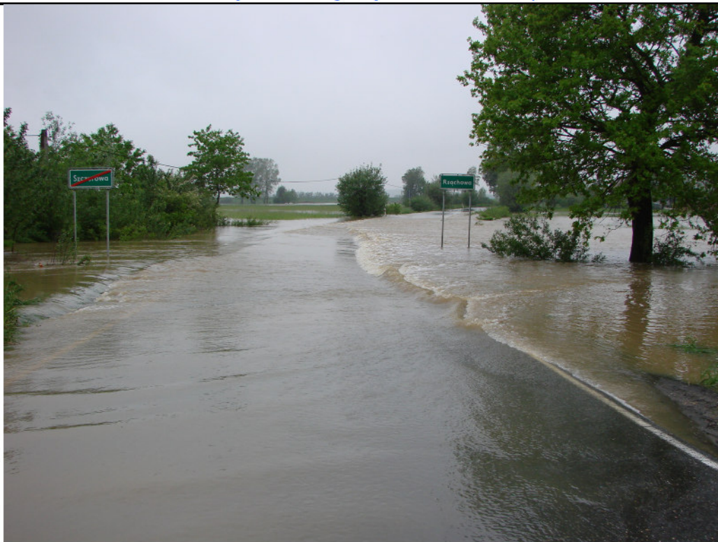
Szkody powodziowe na DW 768 na odcinku Górka - Szczurowa - Rudy Rysie
